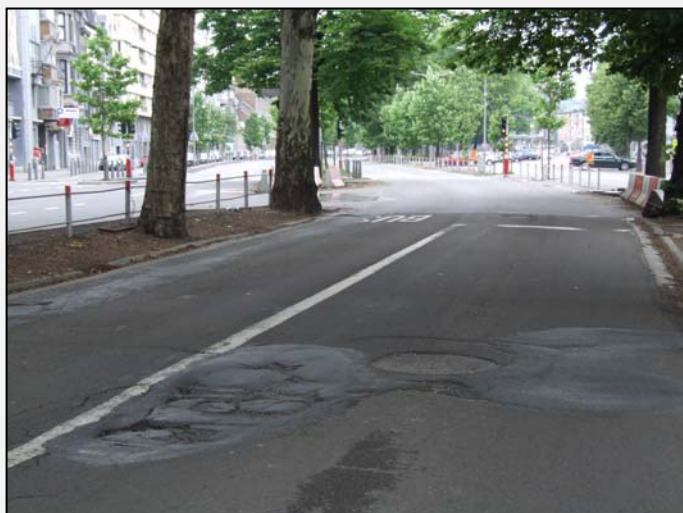
Pour éviter les chocs verticaux, une voirie de qualité est indispensable (idéalement en béton armé continu). L'état des routes et de nombreux sites propres laissent pourtant à désirer comme en témoigne cette photo de la piste des bus sur la boulevard d'Avroy à Liège. © ACTP
